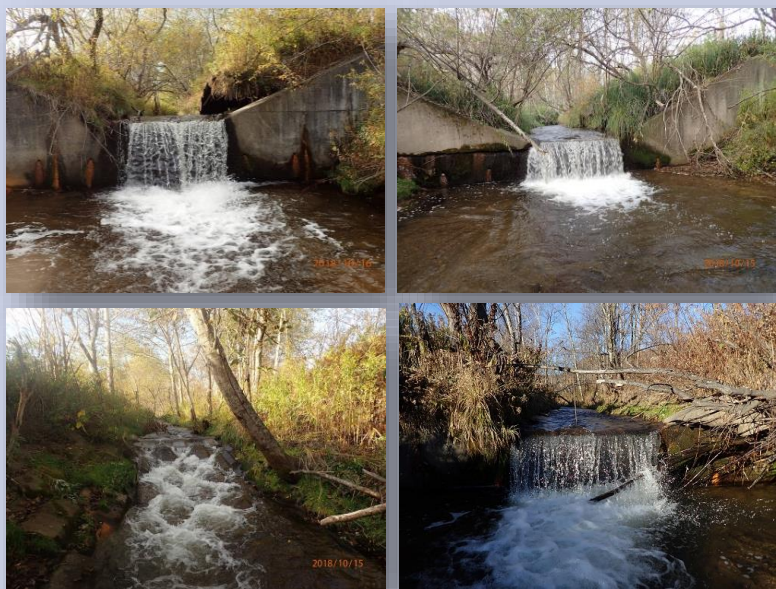
下流： 4基の落差工が遡上障害
